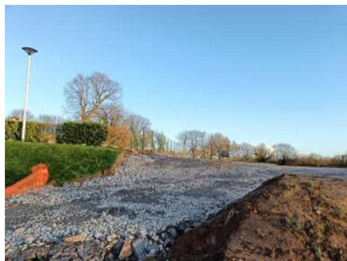
▲ Début des travaux pour l'Accueil de Loisirs qui sera situé près de l'école Le Petit Prince
